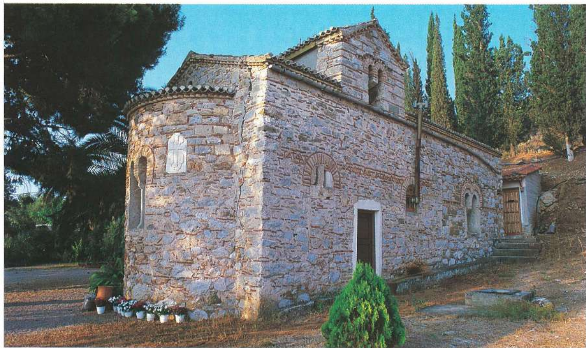
Ο αναστηλωμένος ναΐσκος της βυζαντινής Μονής της Μεταμόρφωσης του Σωτήρος Χριστού(1250), με το καμπαναριό που όμως έχει εμφανίσει κάποιες επικίνδυνες ρωγμές.
