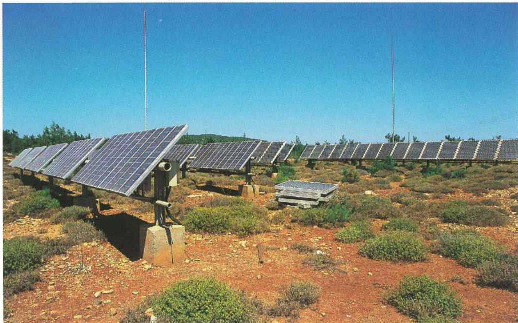
Η φωτοβολταϊκή μονάδα παραγωγής ηλεκτρικού ρεύματος σ' ένα λόφο πριν απ' το Καστρί, εξυπηρετεί σ' ένα βαθμό τις ανάγκες των κατοίκων στο Καστρί και στα Βατσιανά.
