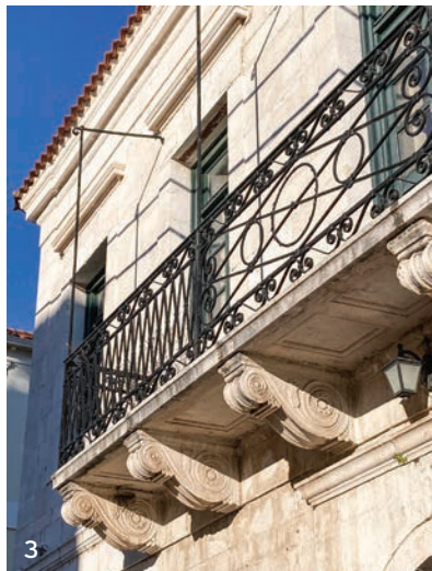
3. Νεοκλασικό Φ. Νικήτα στην γωνία των οδών Βασιλέως Γεωργίου και Βασιλέως Κωνσταντίνου.
